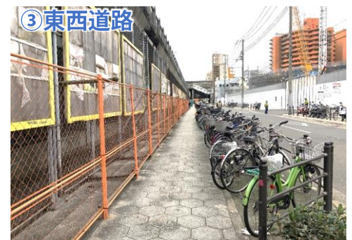
駐輪場が設置されている歩道上にフェンスが設置されており、十分な歩行者空間が確保されていない。
